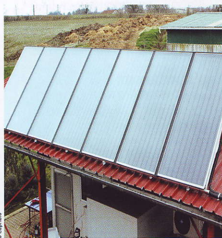
Des capteurs solaires, d'une superficie de 20 m 2 , ont été installés pour la production d'eau chaude.
